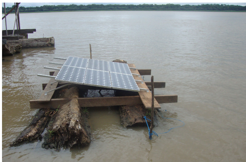
1c) Balsa flutuante com os módulos solares e a bomba d'água
