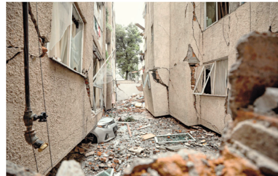
Colapso de estructura con planta baja débil (Jean Ingenieros)
