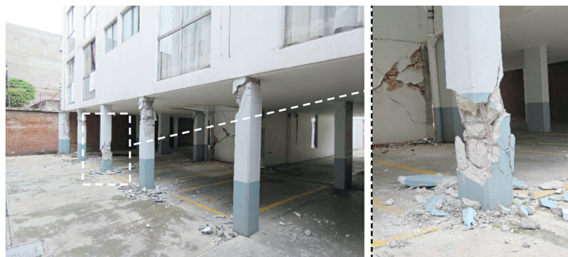
Planta baja débil. Columnas con escaso refuerzo transversal (Dr. Eduardo Miranda)
