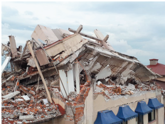
a) Daños en un edificio en Cuernavaca
