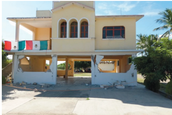
b) Casa de mampostería con grandes aberturas
