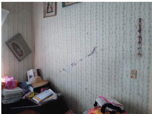
a) Daño medio en muro de carga
