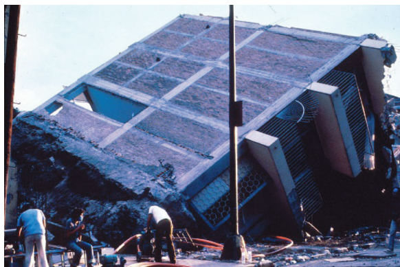
a) Edificio colapsado en la colonia Roma
