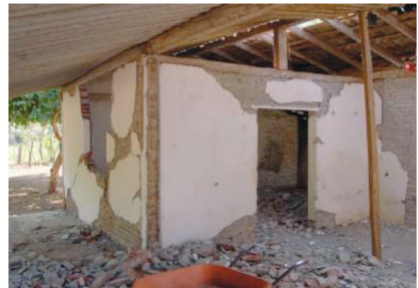
b) Daños en mampostería simple
