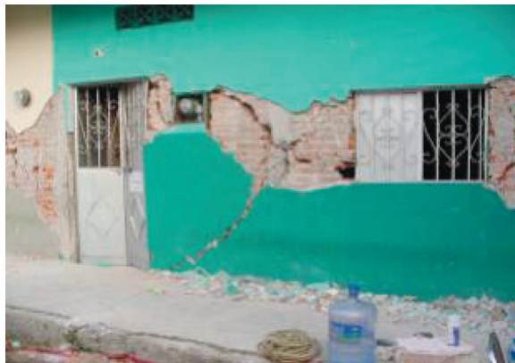
a) Daño severo en Villa de Álvarez
