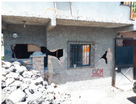
b) Colapso de muro de carga
